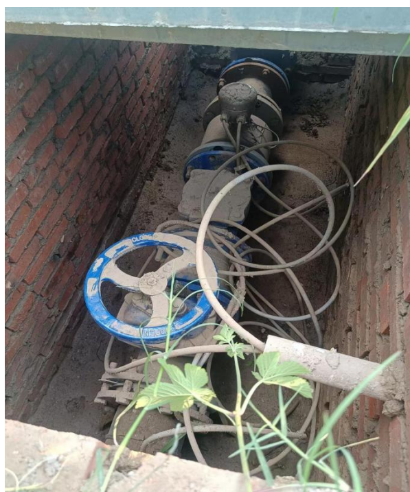
废水总排口照片
